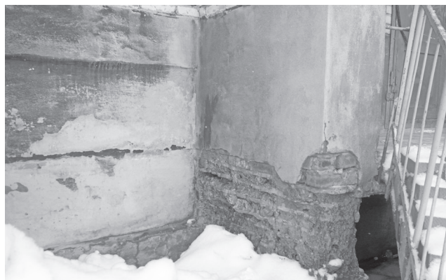
■ крыльцо требует ремонта
