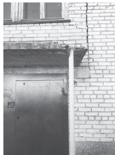
■ Козырек требует ремонта
