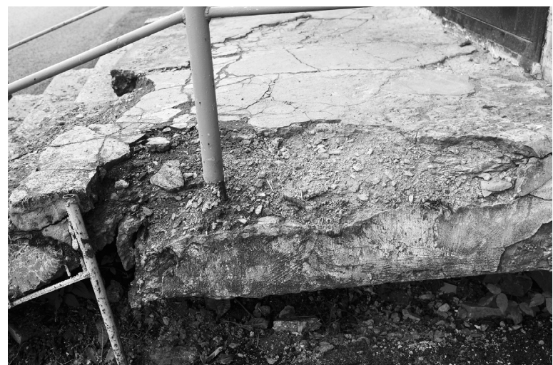
■ Крыльцо требует ремонта
